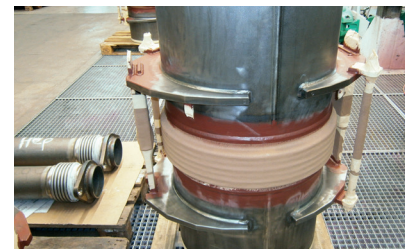
Für den Mehrfachanstrich der C-Stahl Rohrteile werden alle Edelstahlkomponenten und Durchgangsbohrungen abgeklebt
